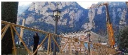
Trabajos de montaje, ayer por la mañana, de la grúa que se utilizará para remodelar el tejado del hotel Abat Cisneros
