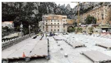
A los dos niveles inferiores ya se instalan las placas de acabado (izquierda). Situación del nivel superior (derecha) marta pich
